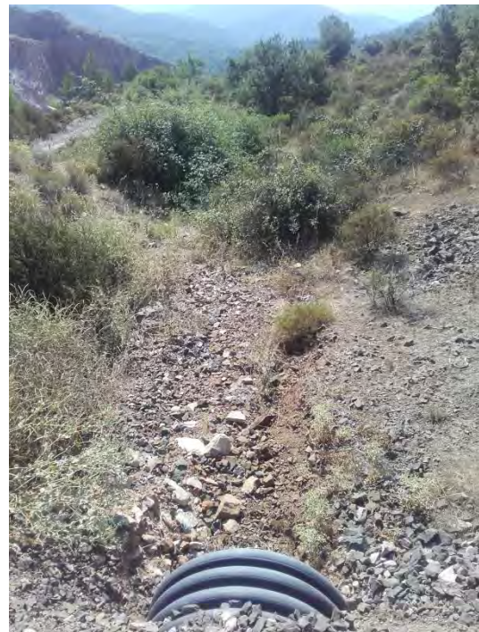
Photographie 6 : Sugitte à sec, en aval de la buse Φ800 mm (source : BURGEAP, le 23/07/2019)
