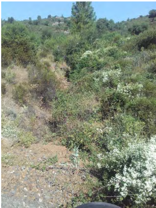
Photographie 5 : Sugitte à sec, en amont de la buse Φ800 mm (source : BURGEAP, le 23/07/2019)
