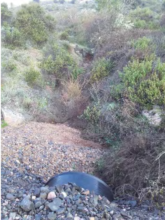
Photographie 1 : Sugitte à sec, en amont de la buse Ø800 mm (source : BURGEAP, le 18/04/2019)
